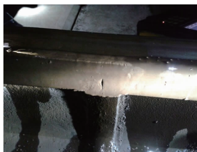
(b) 钢轨焊接缺陷照片
