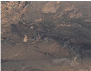
图7 输油管线表面腐蚀宏观形貌
